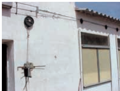
Sistema de apertura automática de las persianas.
