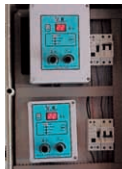
Cuadro de control automático de condiciones ambientales de la sala.
