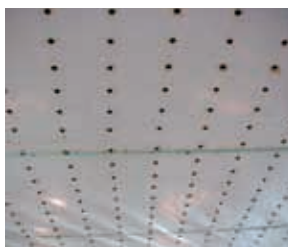
Entrada de aire por el techo.
