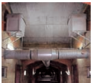
Generadores de aire: se trata de una calefacción ambiental. Producen aire caliente.
