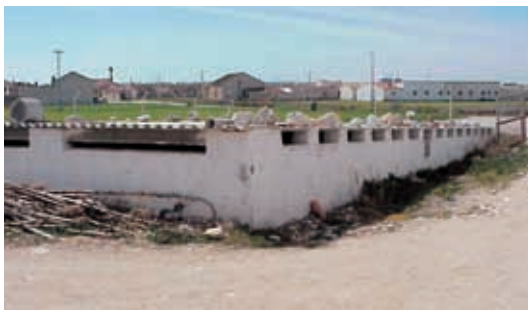
Balsa de purín tapada para evitar que el agua de lluvia caiga en su interior.
